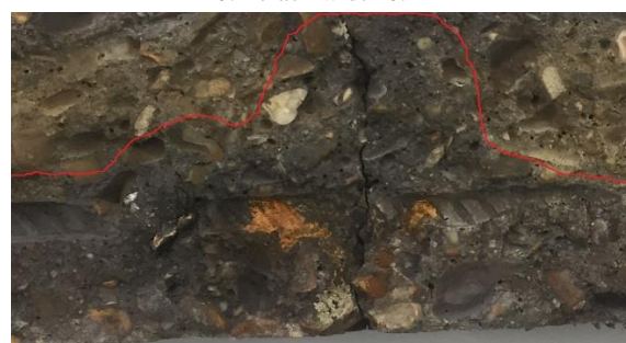
M 0.5-crack width 0.1 mm
