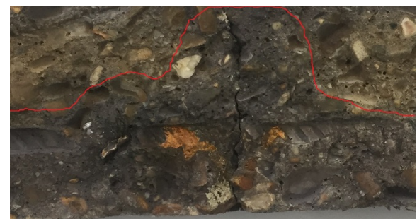
M 0.5-crack width 0.1 mm
